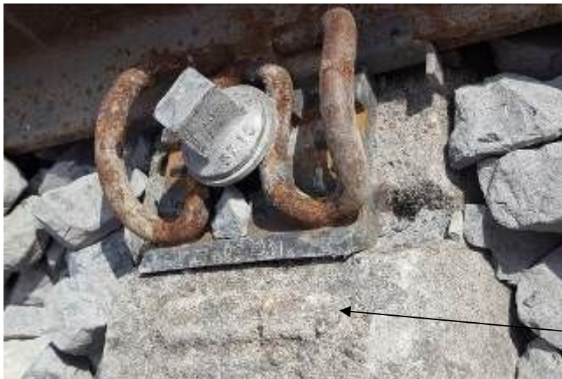
Abbildung 1: Betonschwelle mit Höcker an der Sicken Schulter
