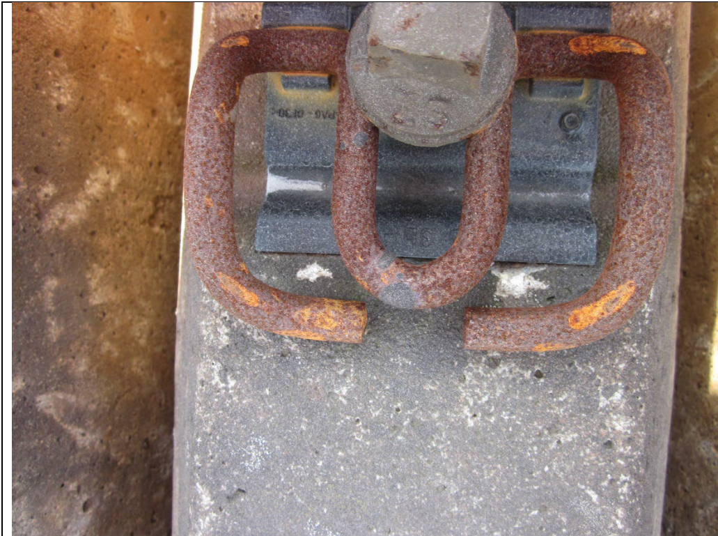
Abbildung 13: Beispiele zu Bereich 1: Oberflächlicher Abrieb an dem Auslagepunkt der Spannklemme auf der Sickenschulter. Kann zulässig sein, solange der Abrieb ausschließlich an der Oberfläche ist und nicht in den Betonkörper hinein gewirkt hat.
