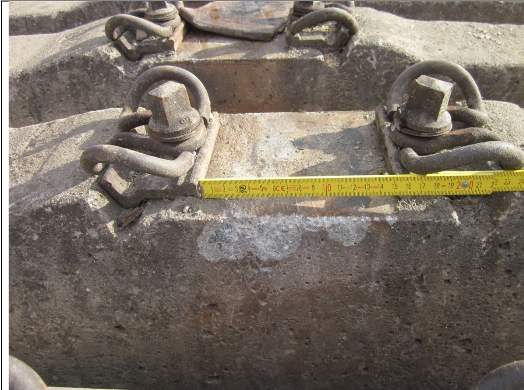
Abbildung 11: Beispiel zu Bereich 1: Seitliche kosmetische Abplatzungen vernachlässigbarer Tiefe an den Flanken des Auflagerbereiches. Hier ist keine Abplatzung in die horizontale Fläche des Schienenauflegers erkennbar. Entsprechend ist die Abplatzung zulässig.
