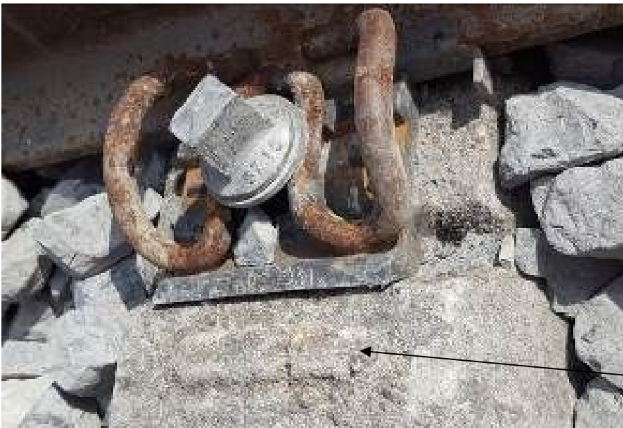
Abbildung 6: Betonschwelle mit Höcker an der Sicken Schulter.
