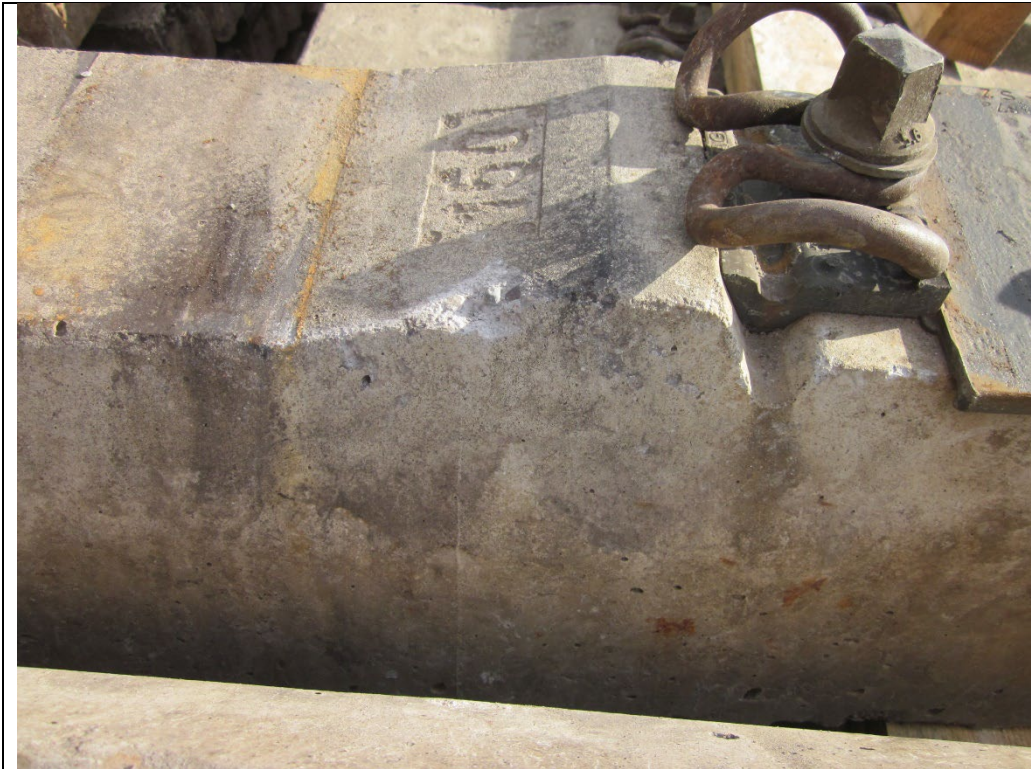
Abbildung 16: Beispiele zu Bereich 2 (übriger Schwellenkörper): Kleine Abplatzung an der Steigung zur Sickerschulter. Zulässig, da Tiefe geringer als 1 cm und Breite geringer als 6 cm.
