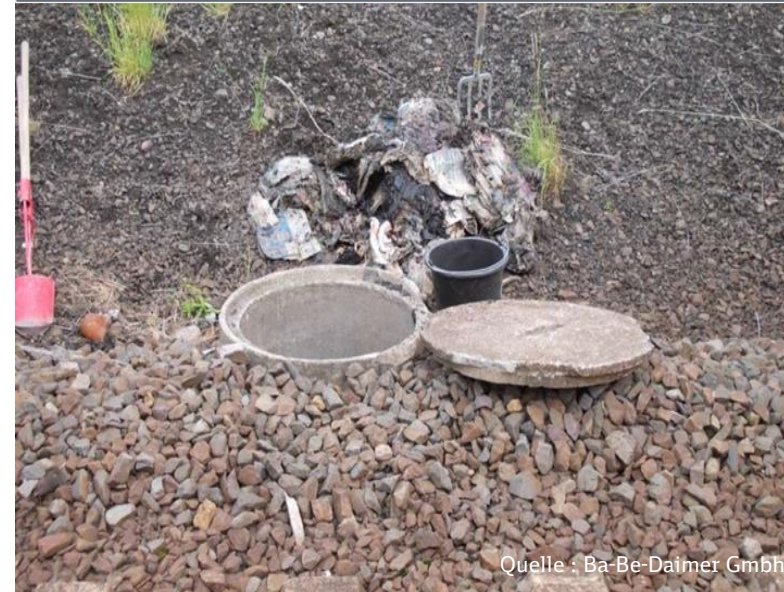
Gestörte Entwässerung, z.B. durch Abfälle im Entwässerungsschacht
